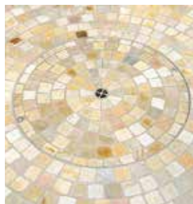
Schachtabdeckung ausgeplastert rund
